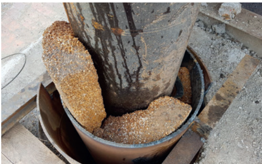
Abb. 2: Verhärtetes Kiesmaterial im Ringraum bei der Bergung nach Überbohrung
